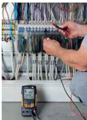
Contrôle de tension sur une armoire électrique.
