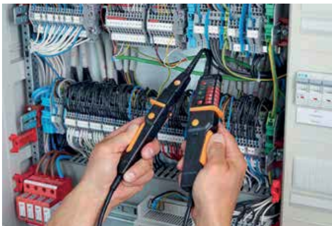
Mesure de tension sur une armoire électrique.
