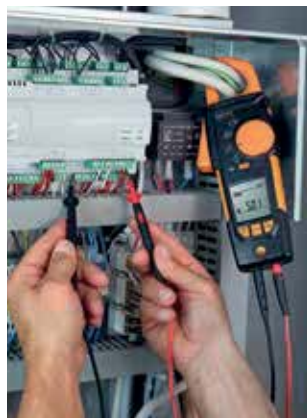
Mesure de la tension sur le tableau de commande d'une pompe à chaleur.
