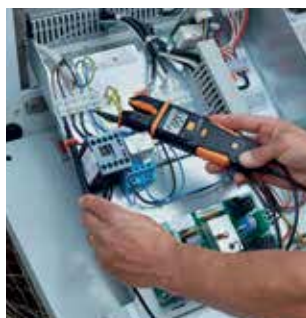
Mesure de tension sur un compresseur.
