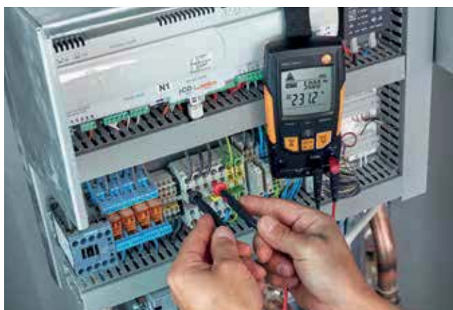
Contrôle de tension sur le tableau de commande d'une pompe à chaleur.
