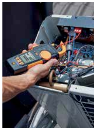
Mise en place de la pince multimètre sur une unité frigorifique extérieure.
