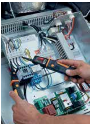
Mesure de tension sur un compresseur.
