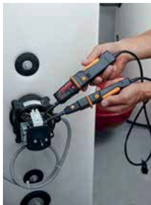
Mesure de tension sur une installation de chauffage.
