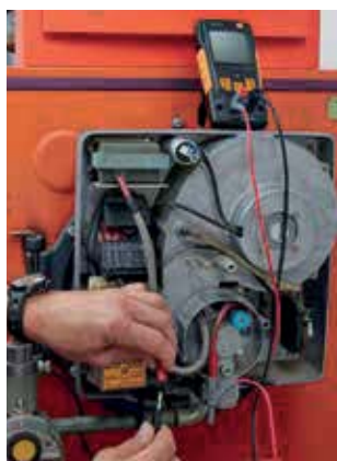
Contrôle de la sonde d'ionisation.
